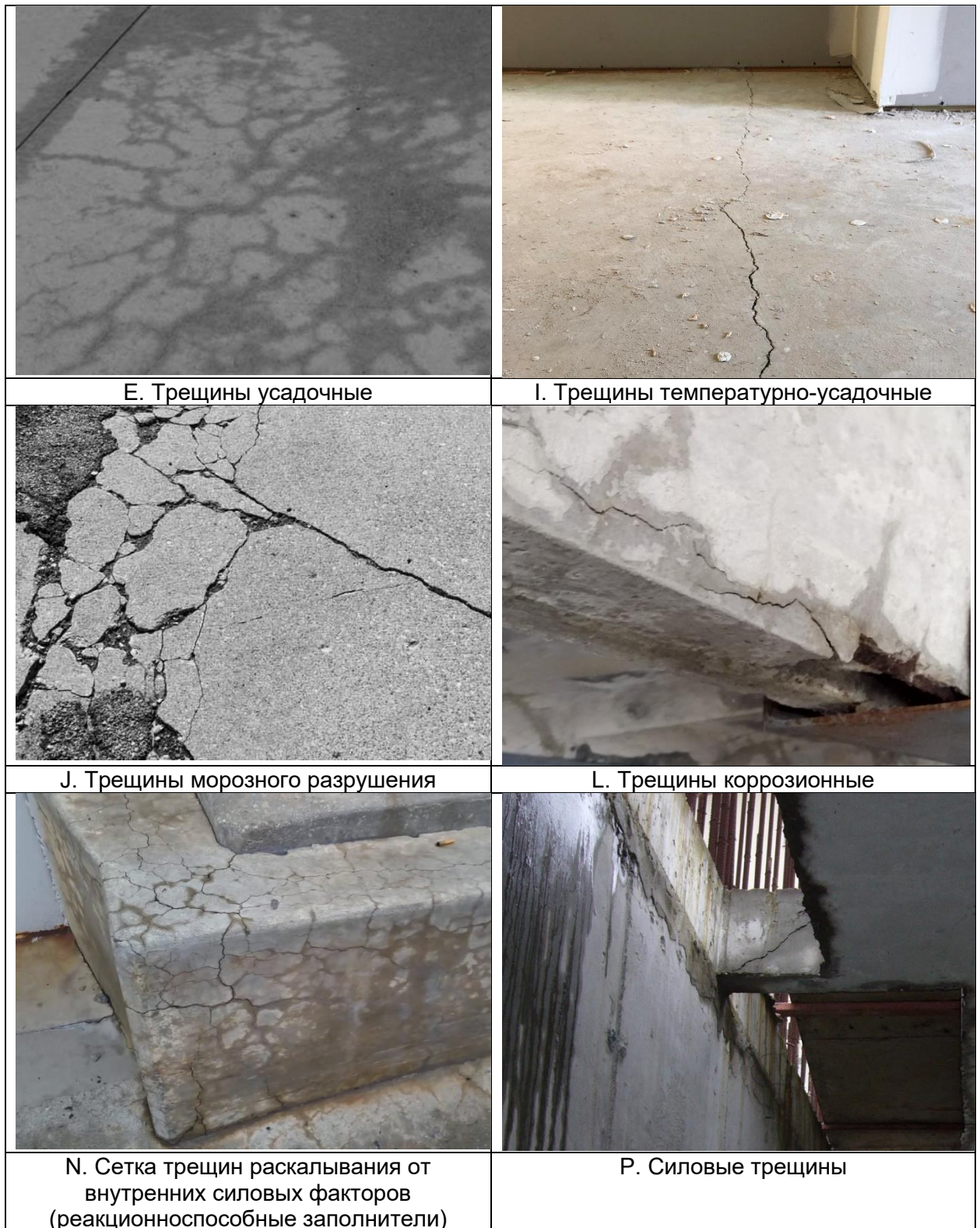
Рисунок Б.3 Характерные трещины в железобетонных конструкциях. Фотоизображения.
