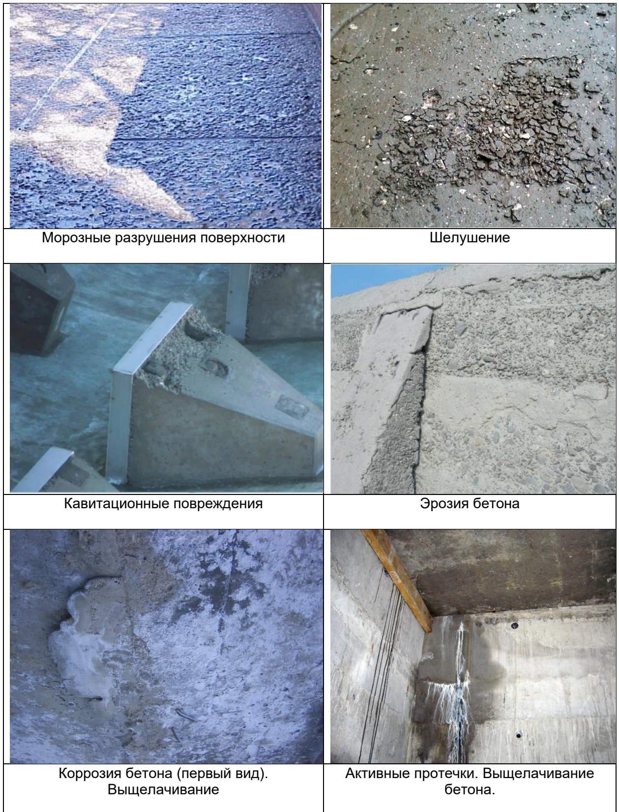
Рисунок Б.7 Характерные дефекты при эксплуатации железобетонных конструкций. Фотоизображения.
